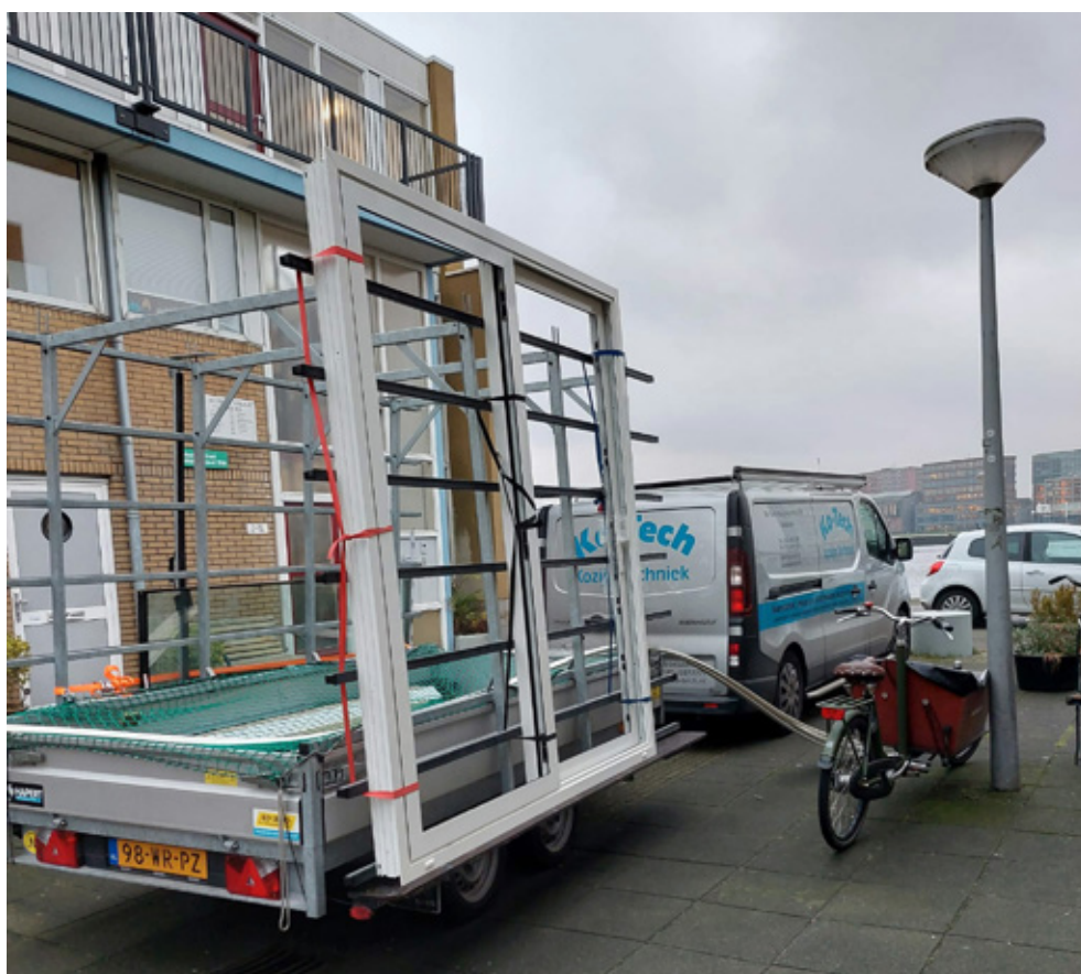
December 2021: weer een kapot kozijn bij Buitendok vervangen
