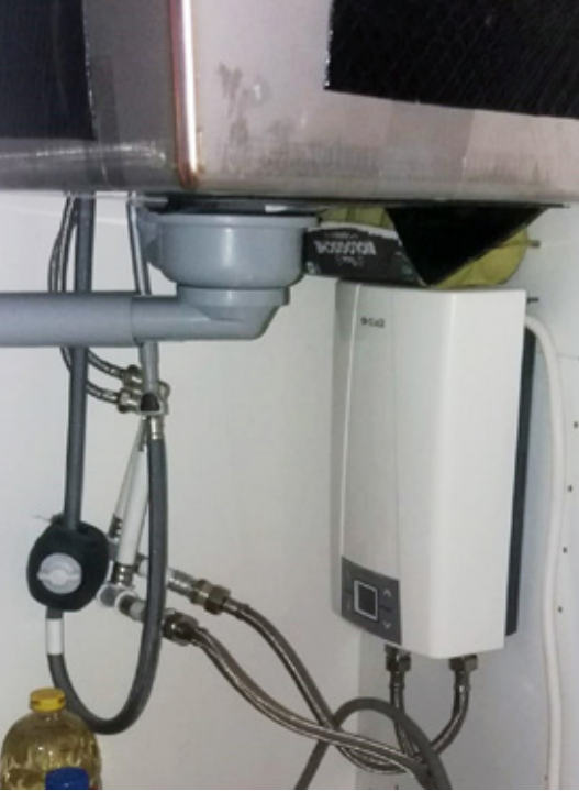
Aardgasvrij bij Buitendok. Warm water uit de doorstroomboiler
